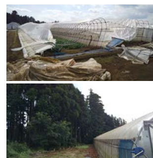
図 7. 被害を受けたハウス(上)と平地林により被害を免れたとみられるハウス(下)（千葉県八街市）
